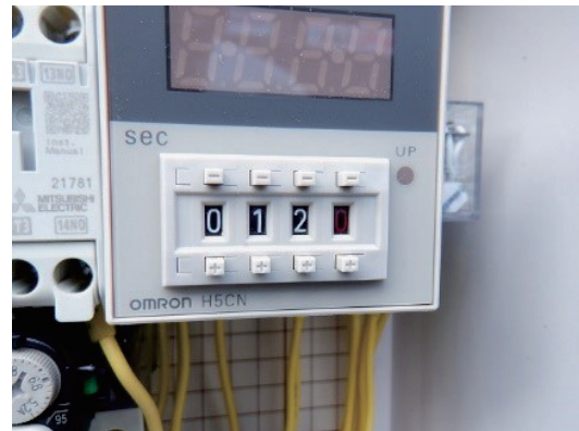
写真-9 操作盤の投入時間設定状況
