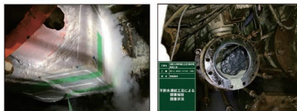
▲排泥管凍結状況 ▲排泥バルブ閉塞 写真-2 凍結工法による閉塞解除状況
