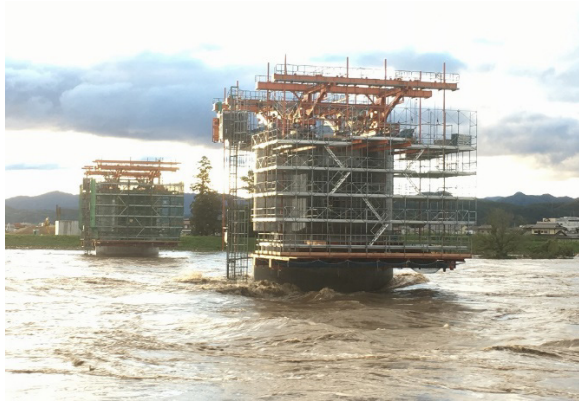
写真-12 河川増水状況
