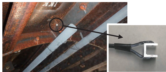
写真-7 POF センサーの設置状況
