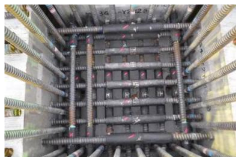
写真-7 梁下筋接続部
