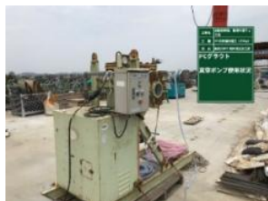
写真-15 真空ポンプ
