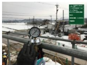
写真-16 中間排気口圧力計
