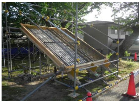
写真-2 モックアップ：スラブ配筋、 レベルアングル施工状況
