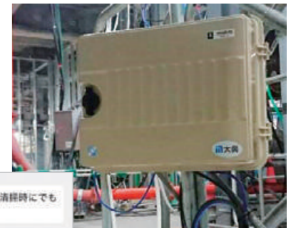
場内用のWi-Fiルーター
