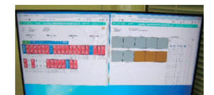
入坑状況確認用モニター(管理室)
