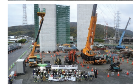
新名神高速道路 高槻高架橋東(下部工) 工事作業所(大阪府)
