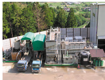
返送機能付き濁水処理設備
