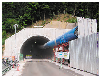
サイレンサー付き坑内換気設備
