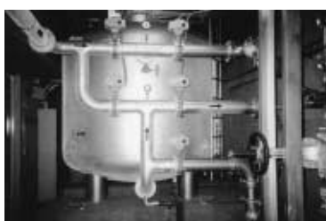
雨水循環装置
